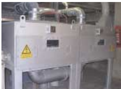
Bild 8: NTP-Anlage zum Abbau von Geruchsemissionen
